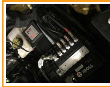
SA Electrical Box
