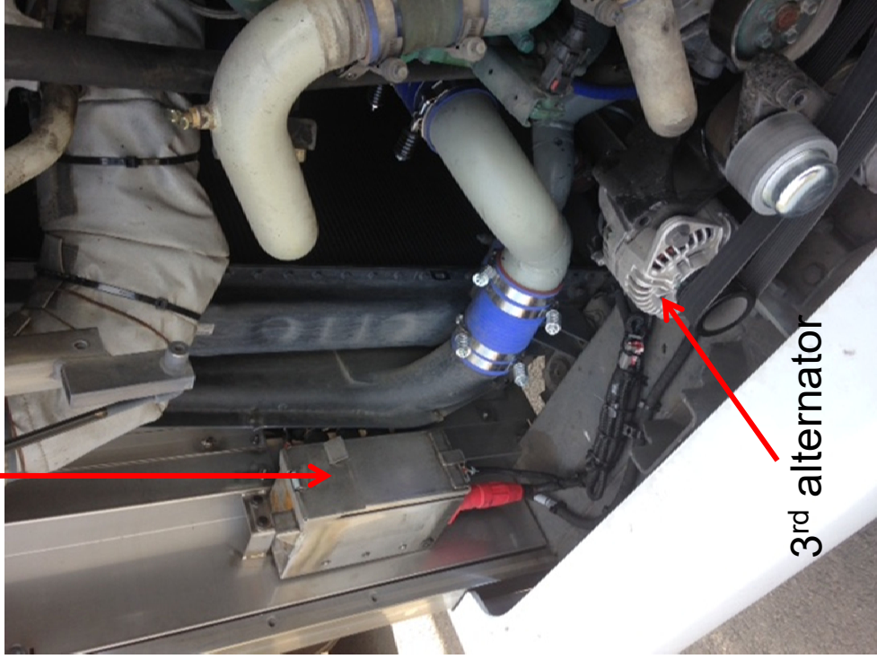
Fan power BOX
